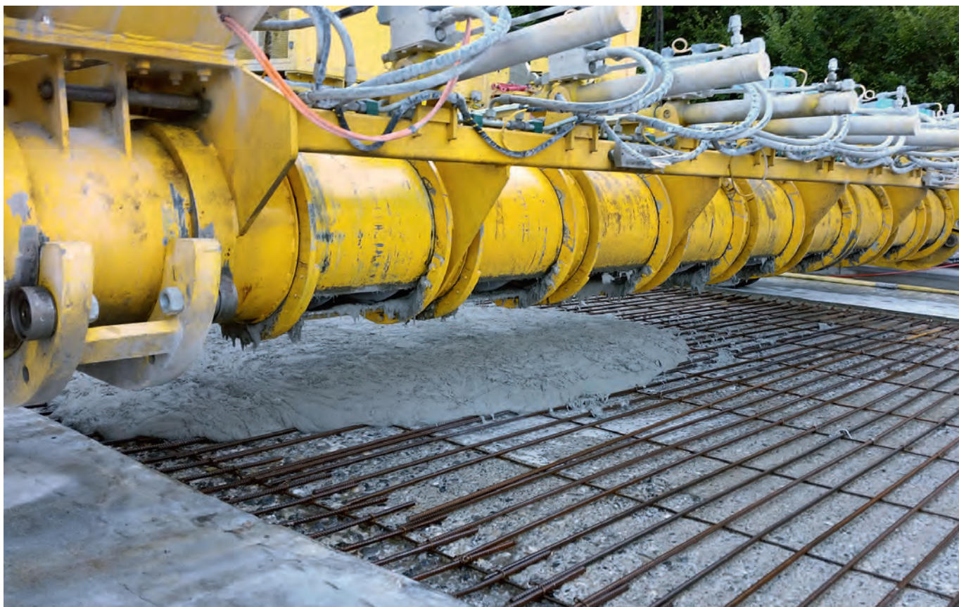
Mise en place mécanique d'une couche de renfort en Ductal® avec un finisseur (viaducs de Chillon).
