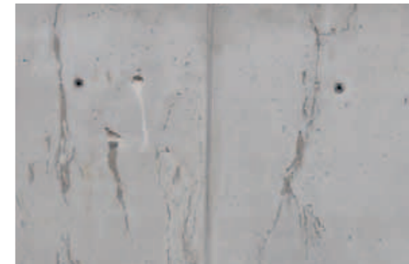
Fig. 43 Remontées d'eau le long du coffrage.
