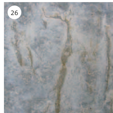
Fig. 27 Poudrage engendré par un surdosage du produit de décoffrage.
