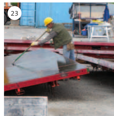
Fig. 23 Répartition uniforme du produit de décoffrage à l'aide d'une raclette en caoutchouc.
