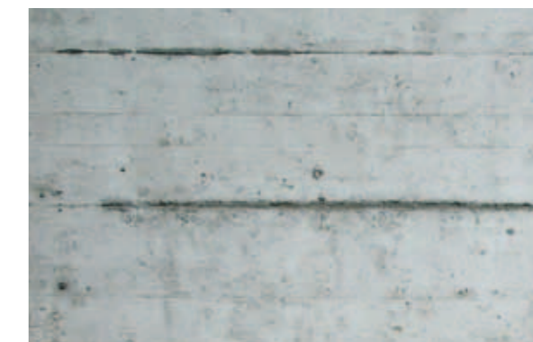
Fig. 20 Joints de coffrage présentant des défauts d'étanchéité (lignes sombres).
